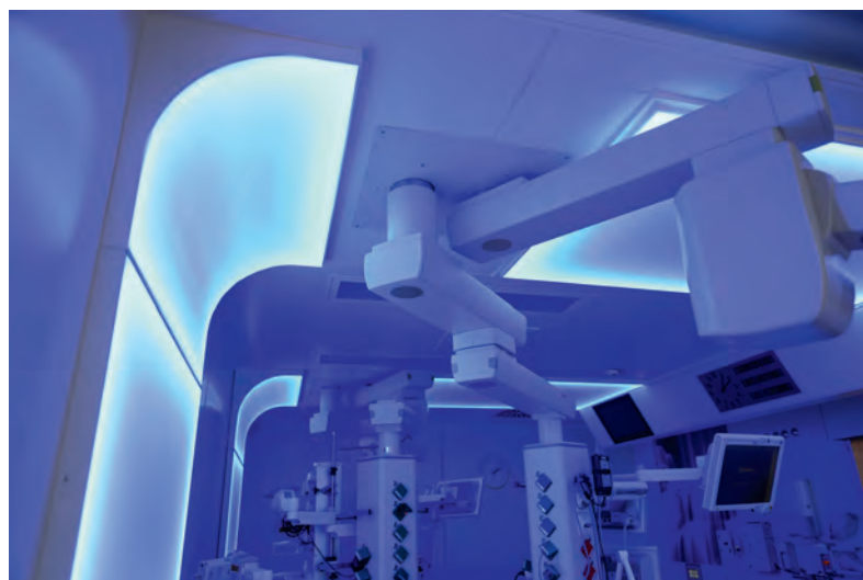
Zwei Intensivbetten im Doppelzimmer mit blauem Stimmungslicht. (Foto: guttenberger+lichttechnik)
